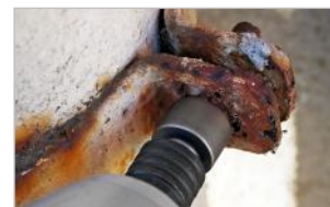
Démontage vis rouillée Rusted screw dismounting
